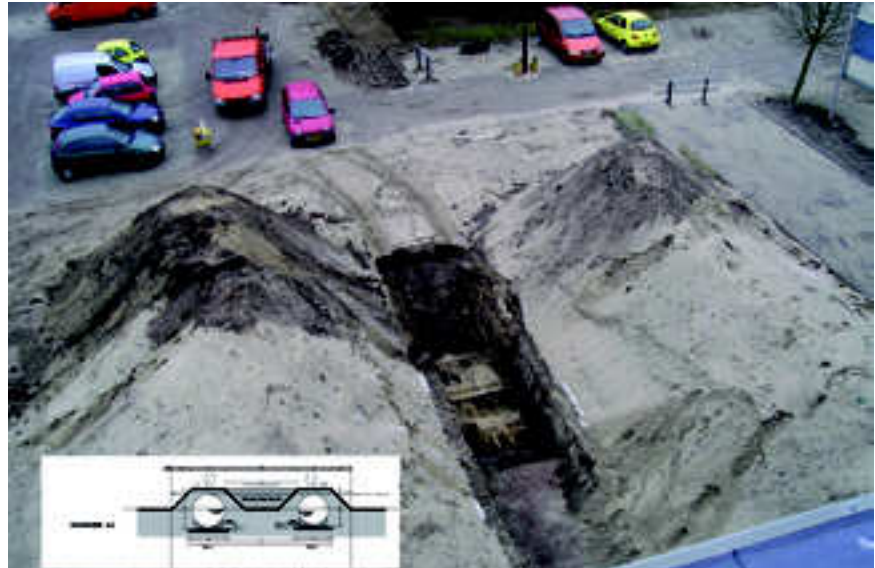
Twee ondergrondse buffertanks
