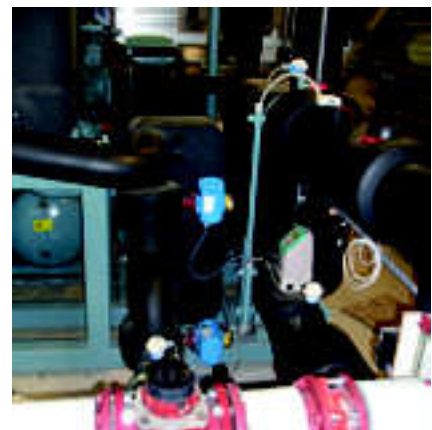
Platenwarmtewisselaar(s) in machinekamer
